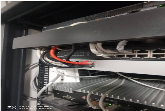
Enlace Cat 6A en switch rack oficina
