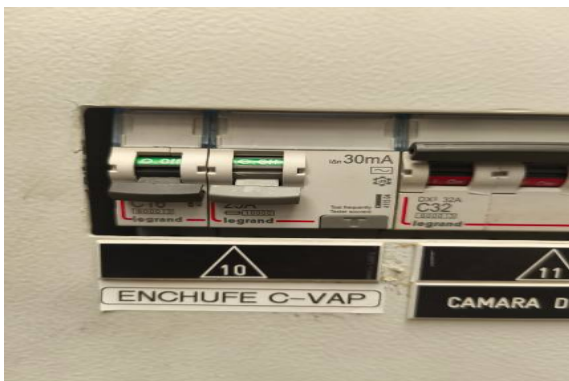
Cto 10 en Tablero
