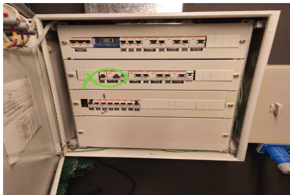
Circuito 6 en tablero
