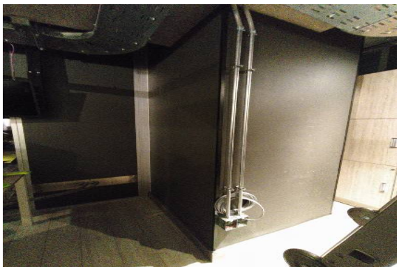
Canalización en muro
